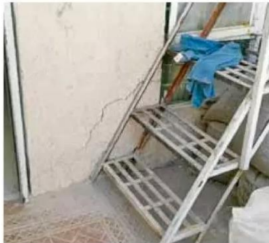
Apuntaladas. Algunas casas tienen daños y los dueños han puesto de su bolsa para repararlas. / HÉCTOR ESCAMILLA
