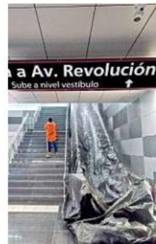
■ Escaleras eléctricas fuera de servicio en la estación Plaza de la Bandera.
