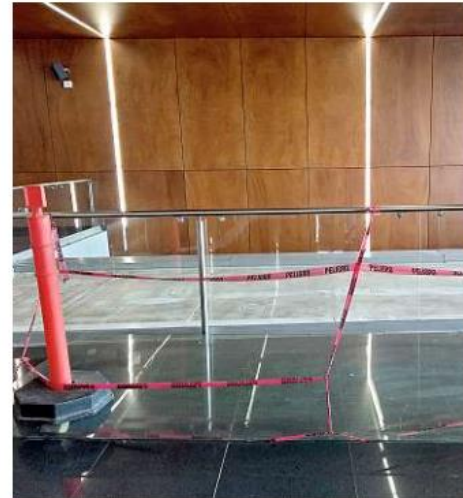
■ Vidrio sobre el suelo, en la parte alta de la Estación CUCEI.
