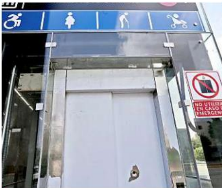
■ Orificios en el elevador de la estación Plaza de la Bandera.
