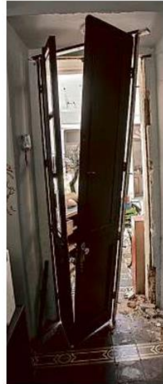
■ La escuela, ubicada sobre Avenida Hidalgo, quedó con las puertas rotas.
