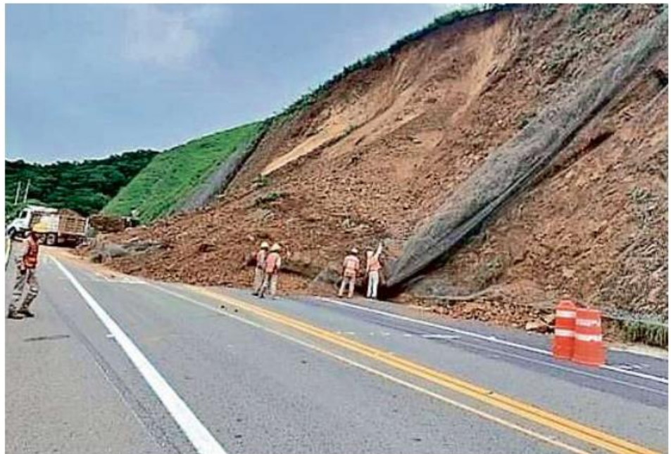
■ La autopista Jala a Compostela, construida por Grupo Carso, de 67.9 kilómetros de longitud, cumplió más de un mes de estar cerrada por trabajos de reparación de taludes.
