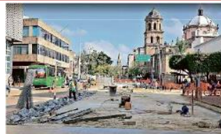
Trabajadores tuvieron que romper la losa y guarnición que recién colocaron en la avenida, porque no iba con el proyecto y no cumplió con pruebas de resistencia.
