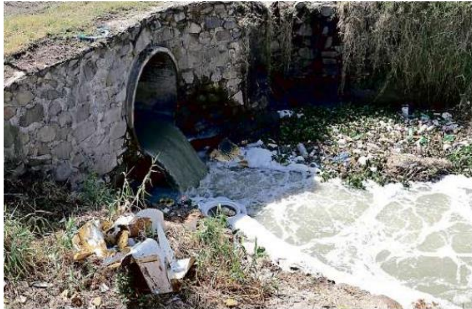
La Presa Las Pintas concentra agua que viene del Lago de Chapala por el Canal de Atequiza y termina en la planta potabilizadora de Miravalle; hoy luce con basura y líquido turbio.
