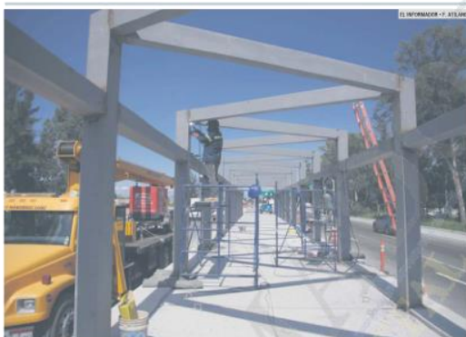
OBRAS. De acuerdo con la Secretaría de Infraestructura y Obra Pública (SIOP), las estaciones del Peribús registran un avance de 25% y los carriles laterales están en 75 por ciento. Se prevé que todo concluya durante la segunda mitad de 2021.
