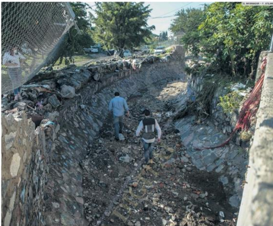
CONFLICTO. La Colonia El Garabato fue una de las más afectadas durante el pasado temporal. Faltan más obras y la reubicación de familias en riesgo.
