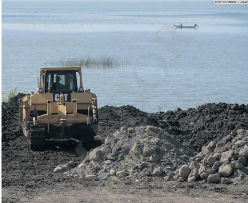
AFECCIONES. Ríos y lagos son los más invadidos por particulares para ampliar sus viviendas. En la imagen, el fraccionamiento El Chante, en Jocotepec.
