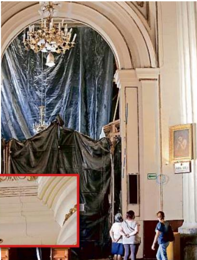
■ Siguen a la vista grietas y dos áreas sin reparar una en cada lado de la entrada principal de la Catedral.
