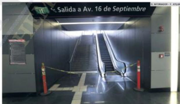
FALLAS. Usuarios piden resolver los problemas en la Línea 3, como en la Estación Catedral.
