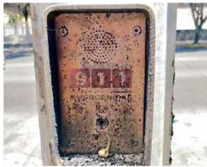
En menos de 5 meses han sido vandalizados 180 postes del C5.
