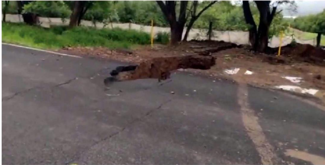
Las precipitaciones provocaron la reapertura de la grieta que se abrió sobre el km 68 + 200 de la carretera 401. ESPECIAL
