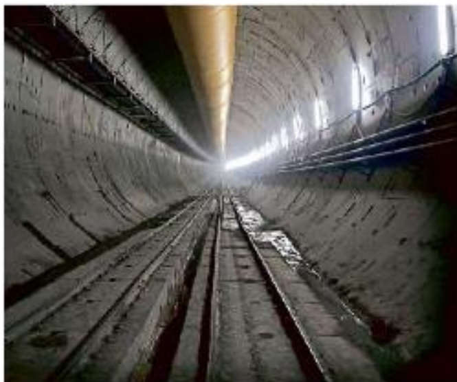
■ Desde su construcción, el túnel ha presentado filtraciones.
