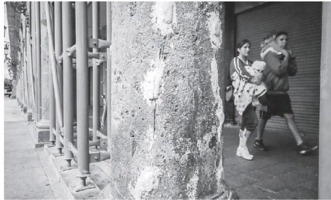
Los pilares, grietas y un mal trabajo de ocultamiento. /FRANCISCO RODRÍGUEZ
