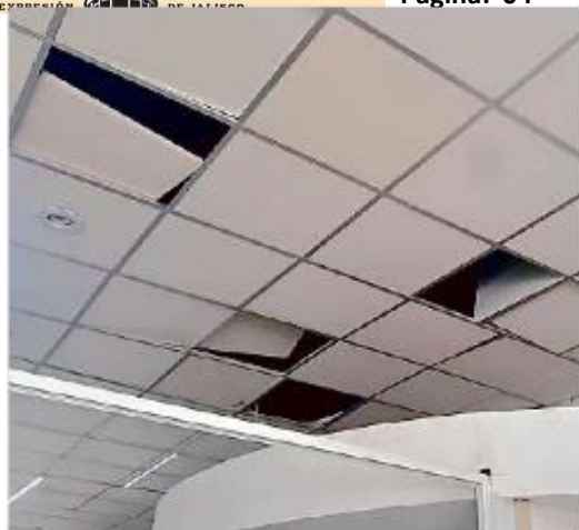
■ Hay techos con plafones dañados en algunas agencias.
