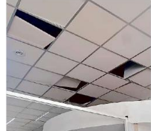
Hay techos con plafones dañados en algunas agencias.
