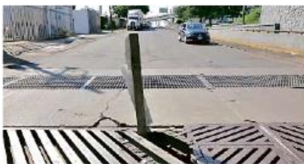
Las bocas de tormenta están dañadas, como en la lateral de Lázaro Cárdenas para incorporarse a la Carretera a Chapala.
