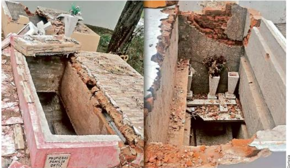
En el Panteón Jardín, en Guadalajara, han destruido tumbas para robar las vigas de las fosas.
