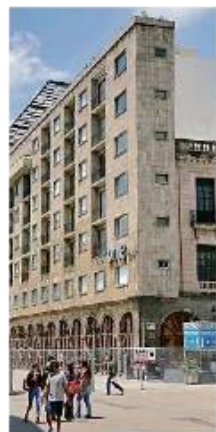
■ El Edificio Plaza, frente a Plaza de Armas, tiene vallas luego de confirmarse daños en su estructura.
