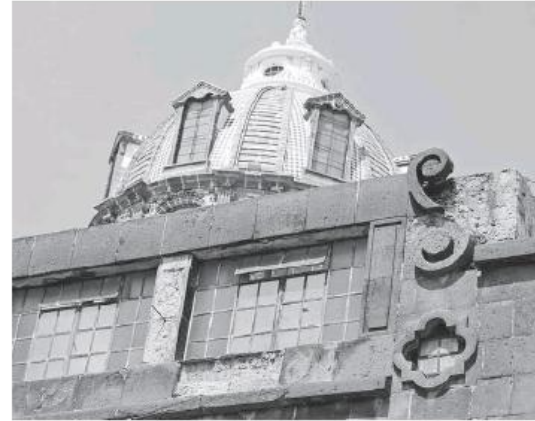
Afectaciones en la cúpula del templo de San José. /ANTONIO MIRAMONTES
