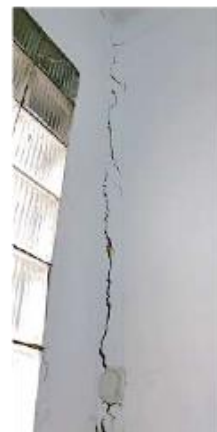
■ Oficinas del Santuario tienen múltiples grietas.
