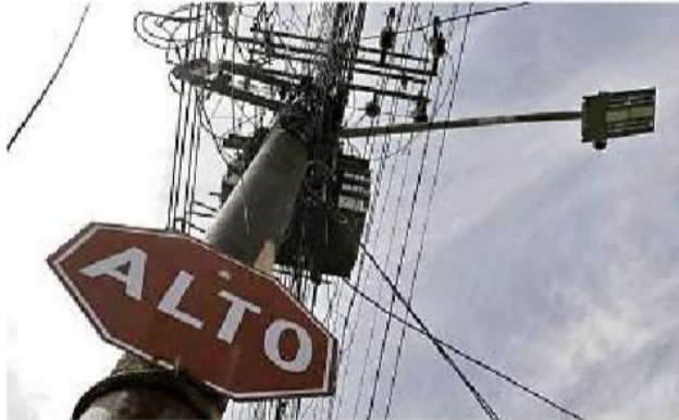
Actualmente el cableado aéreo representa un riesgo.
