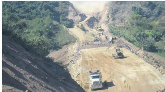
RETRASOS. Los trabajos han tenido contratiempos por temas como la liberación de derechos de vía y la obtención de permisos ambientales.
