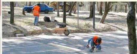
En una visita al Parque Solidaridad se constató que trabajadores se encontraban retirando parte del suelo instalado debido a que olvidaron colocar tuberías.
