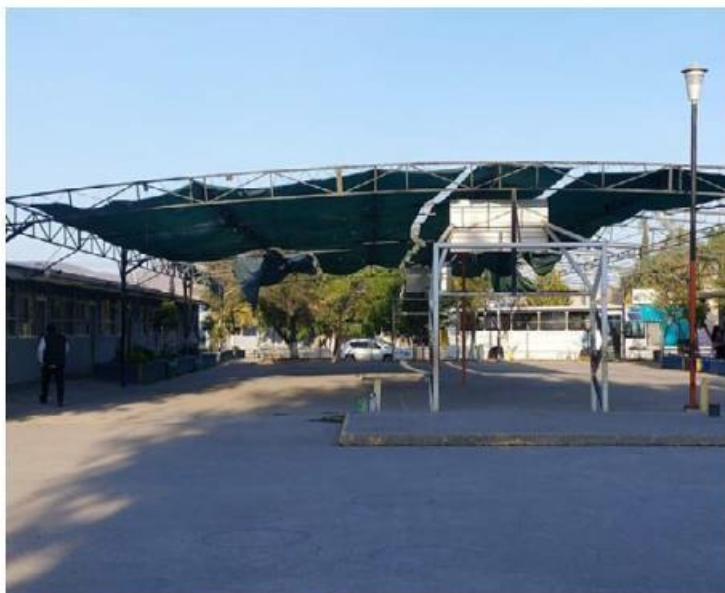
Primaria con problemas de infraestructura. ROSARIO ÁLVAREZ
