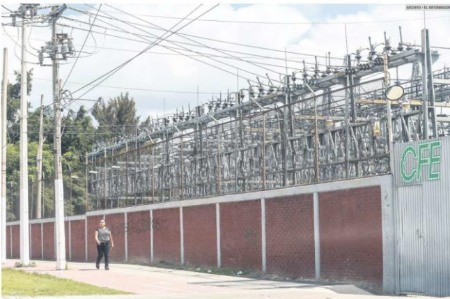
SEÑALAMIENTO. Especialistas remarcan que en plantas de la Comisión Federal de Electricidad se usan combustibles más caros y contaminantes.
