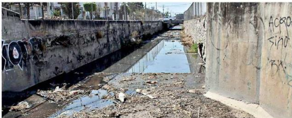
■ La Proepa encontró derrame de aguas domésticas en el Arroyo Seco, en la Colonia El Mante.
