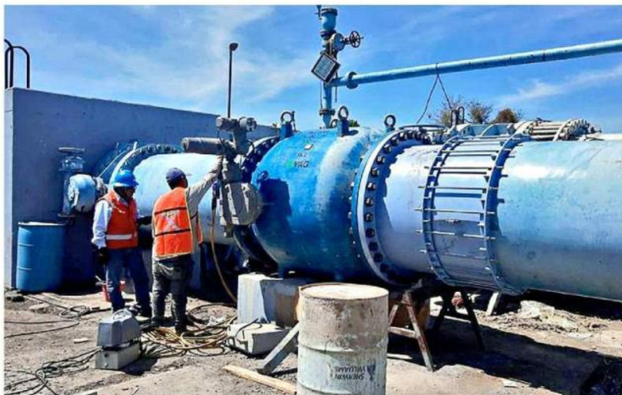
Las labores de mantenimiento a la infraestructura del Siapa, en Semana Santa, dejaron sin agua a más de mil colonias del Área Metropolitana de Guadalajara.
