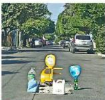
■ Socavón en la Calle Rogelio Bacon, entre Fidel Velázquez y Monte Carmelo.
