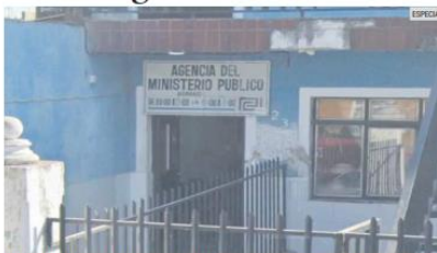
DETERIORO. Así luce la agencia en Poncitlán, donde ocurrió un doble homicidio el pasado 31 de enero cuando un sujeto armado arremetió contra dos mujeres.
