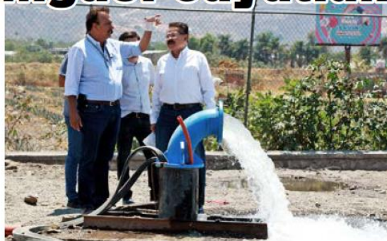
El pozo de agua cumple con todos los parámetros establecidos por norma.
