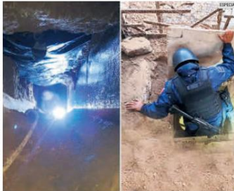
PELIGRO. El túnel fue resguardado por bomberos, militares y agentes de seguridad, pues se registró acumulación de gas.
