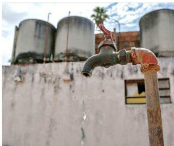
Siapa señala que sí hay servicio, pero que falta presión.
