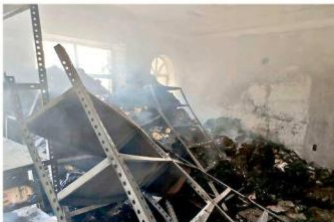
■ Los daños del incendio fueron severos.
