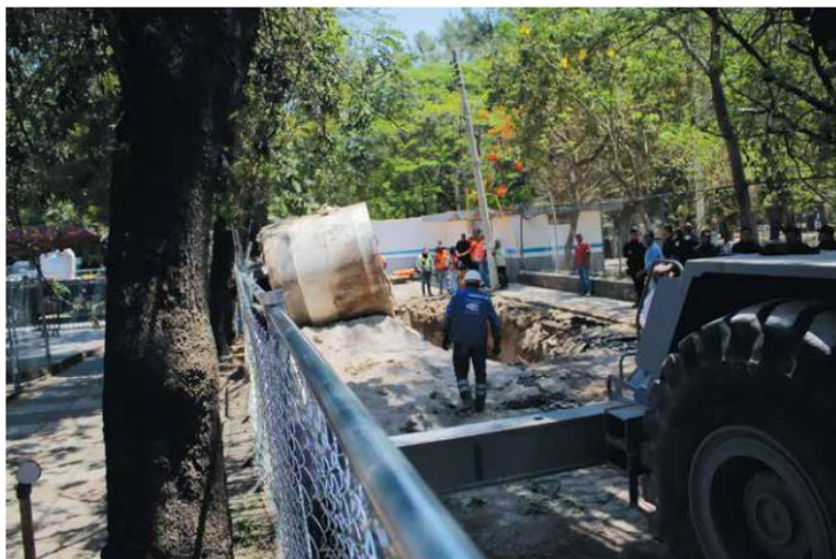
DICEN. Las obras en San Rafael durarán seis semanas, según información del Siapa.
