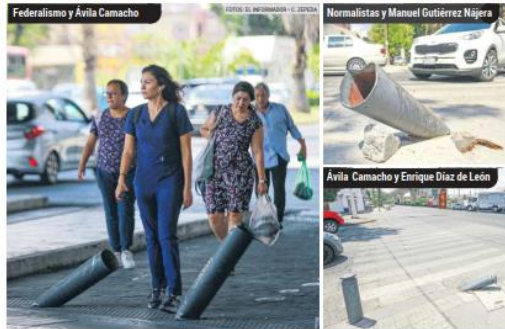
CUIDADO. Durante un recorrido, este medio de comunicación observó bolardos en mal estado que no son atendidos por las autoridades y que también llegan a entorpecer el paso de los ciudadanos.
