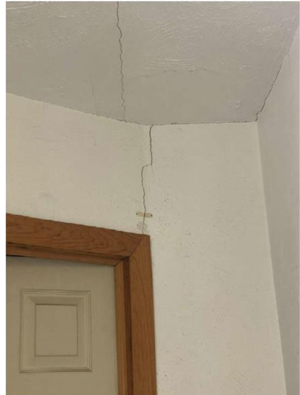
En las casas se aprecian grietas. K.V. RODRÍGUEZ
