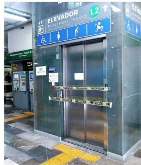
Se han presentado fallas en elevadores del Tren Ligero.
