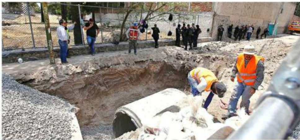
■ Vecinos piden hacer un recorrido, con funcionarios del Siapa, por las obras del colector que se hace en San Rafael.
