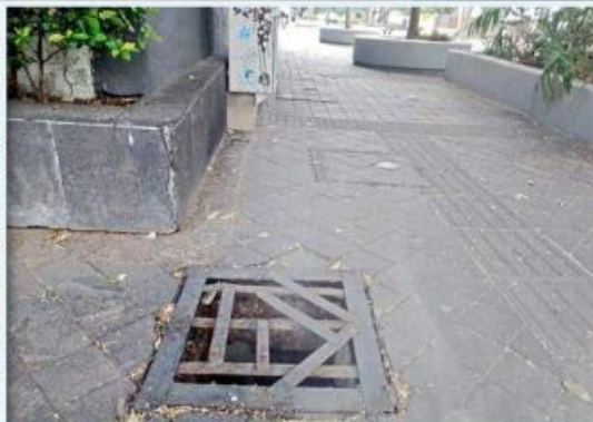
En pleno andador, las rejillas de las coladeras son un riesgo.
