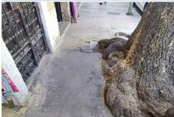
Las raíces de los árboles también afectan las banquetas.
