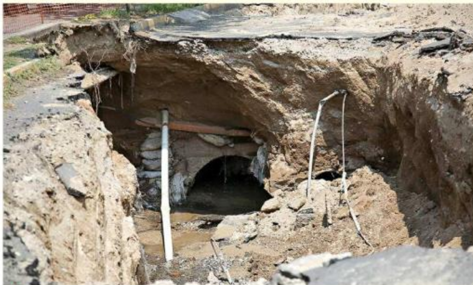
Se generó un socavón de 25 metros de largo.
