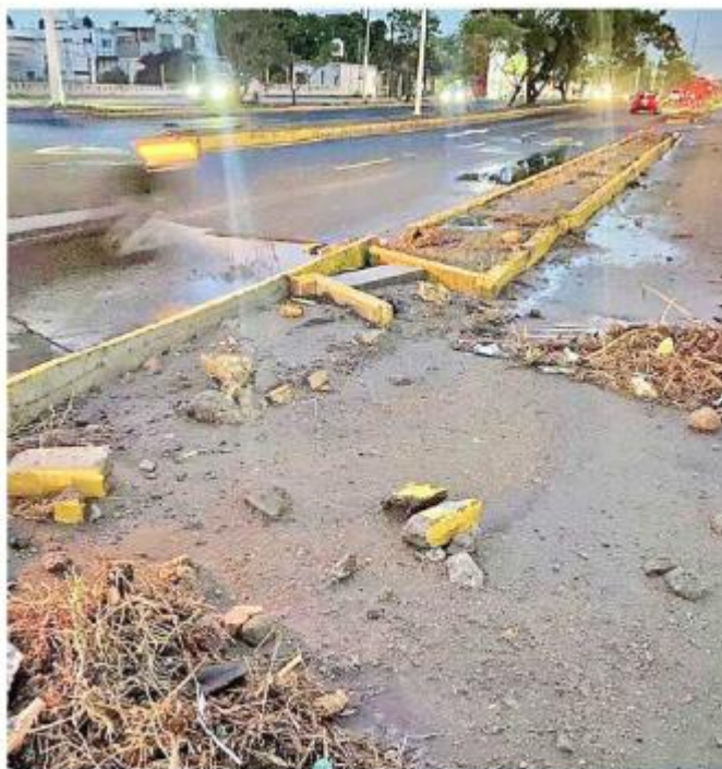
Particulares construyeron tres camellones sobre la Avenida Camino a Bosque de San Isidro, y el agua los destruyó.
