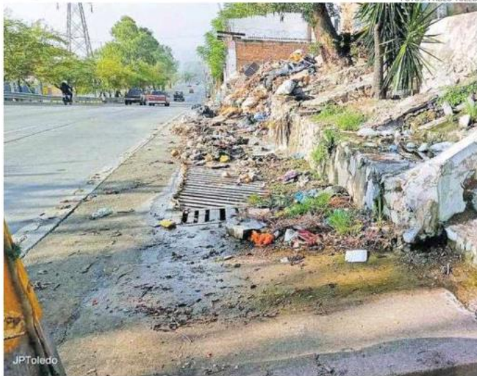
Fuga de aguas residuales y basura sobre Periférico y Salomé Arias, en Oblatos
