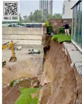
El muro de contención y cimentación cayó y se llevó parte del jardín y patio de las viviendas colindantes.
