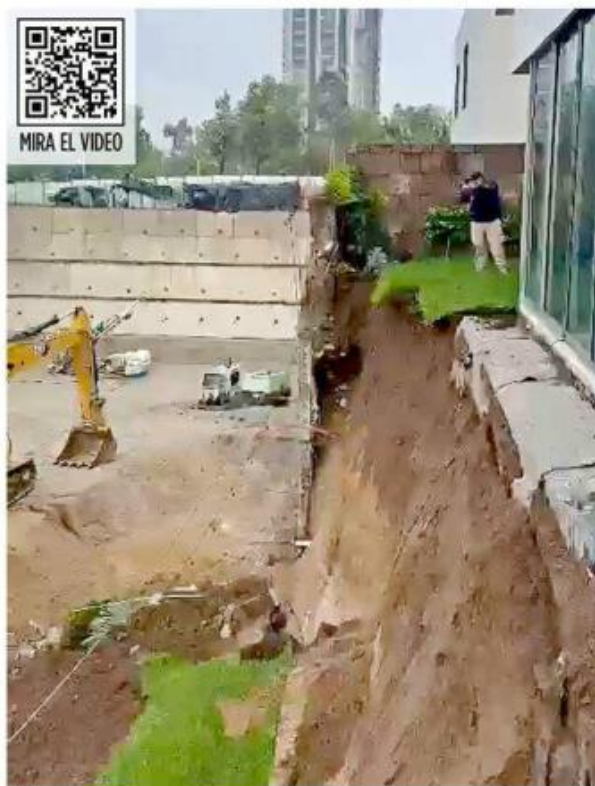
El muro de contención y cimentación cayó y se llevó parte del jardín y patio de las viviendas colindantes.
