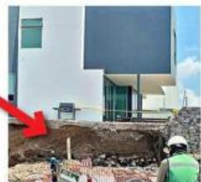
En el subsuelo de las casas se aprecian huecos.
