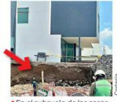
En el subsuelo de las casas se aprecian huecos.
