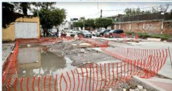
Vecinos dicen que faltan varios tramos.
