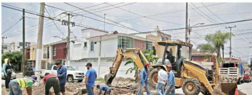
Los trabajos incluyen renovación de redes de agua, drenaje y tomas domiciliarias, así como concreto, ciclovía y banquetas.
