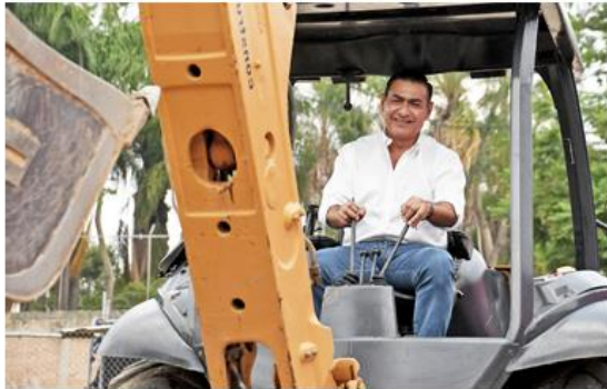
Salvador Zamora encabezó el arranque de construcción de la Calle 24 de Diciembre.
