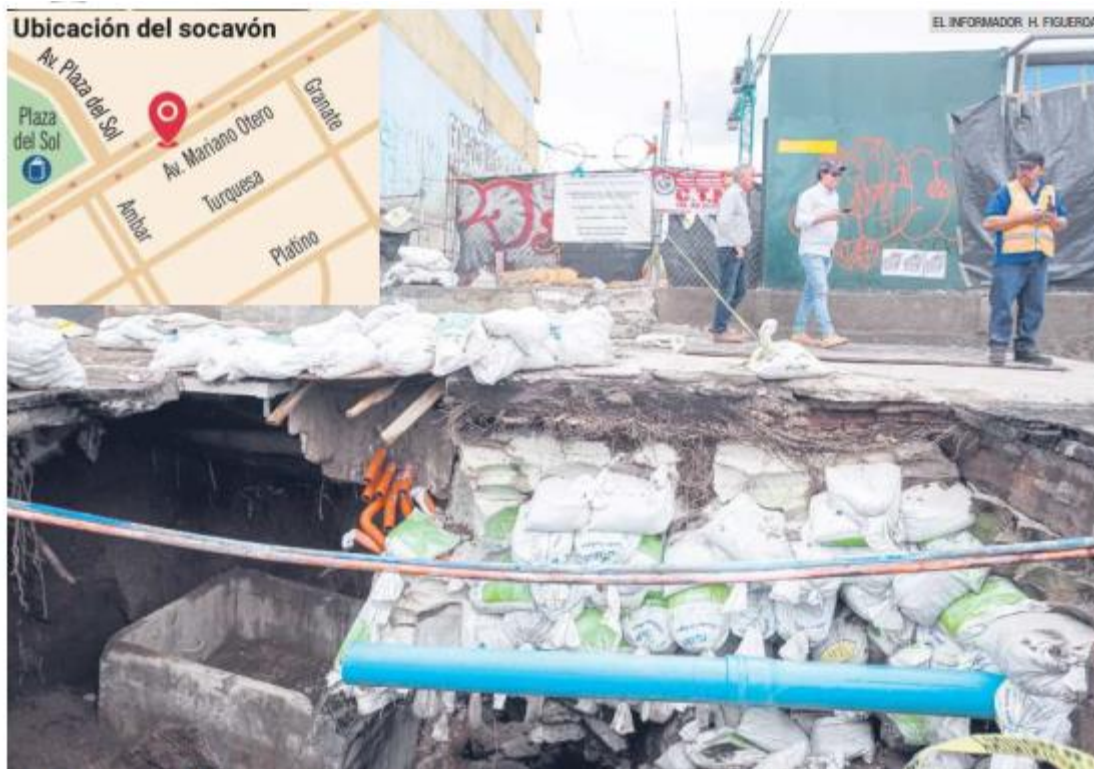
RIESGO. Autoridades y constructores del edificio comenzaron ayer con la reparación del socavón que se formó a causa de las lluvias en el carril lateral de la Avenida Mariano Otero.
