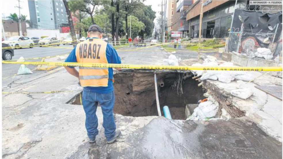
SE REBLANDECIÓ LA TIERRA. Un muro del cimiento de una construcción se deslavó con la corriente de agua.
