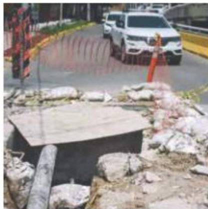
AGANDALLE. Banquetas y calles de quedan inaccesibles para los vecinos por la construcción de torres.
