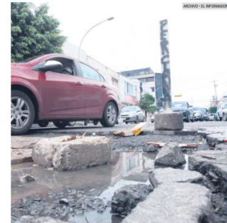
DAÑOS. El agua y la falta de mantenimiento dañan el pavimento, que pronto se vuelve un riesgo para automovilistas y peatones.
