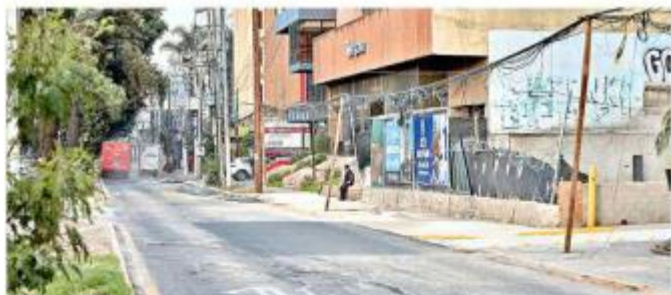
La superficie de rodamiento quedó "parchada" con asfalto.
