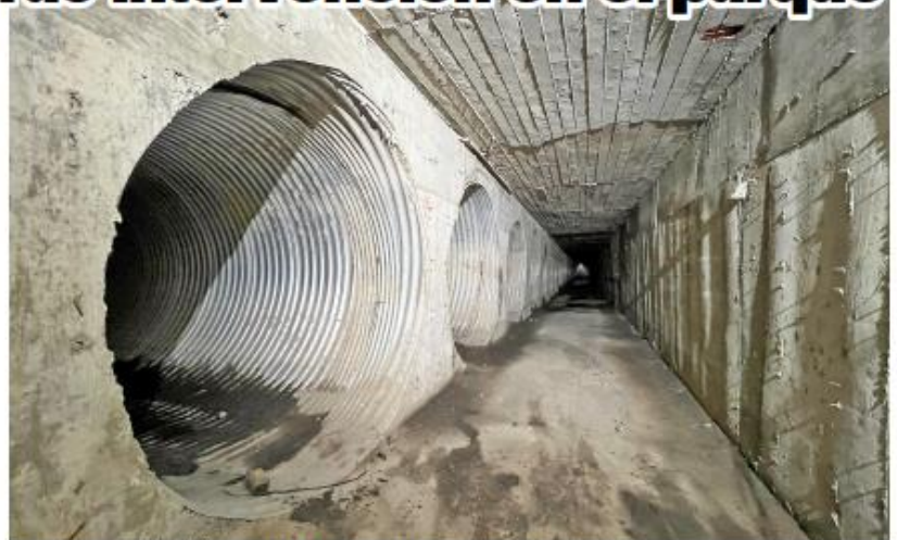
El depósito pluvial tiene capacidad de regulación de 25,000 m 3 .
