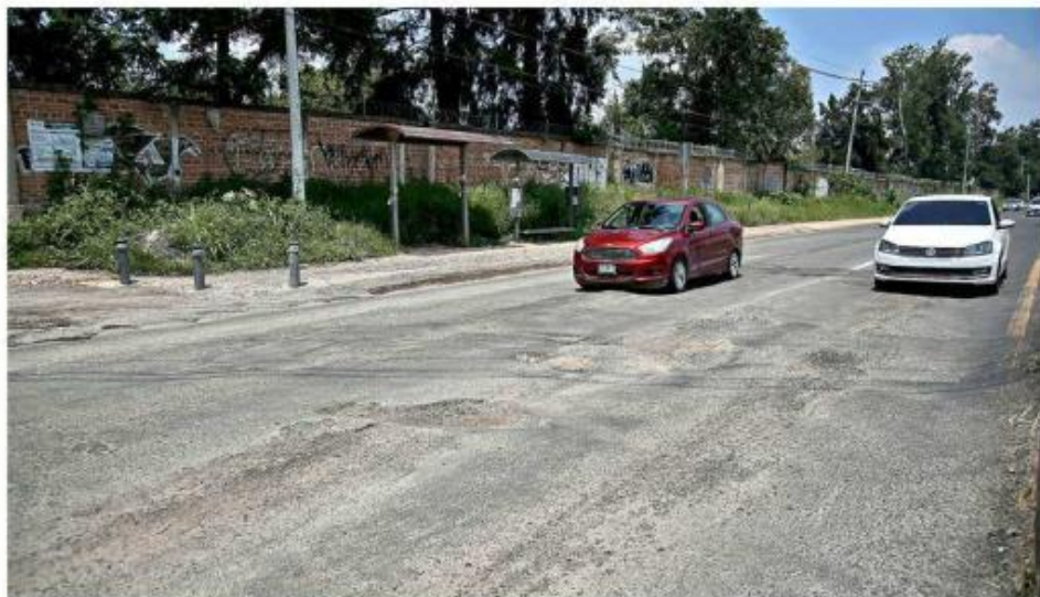
■ Está en mal estado el tramo que va de la Avenida Ramón Corona a Periférico.
