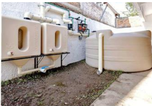
El agua de lluvia recolectada servirá para uso sanitario y de limpieza del Centro de Salud de Juanacatlán.
