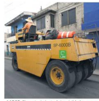
LABOR. El mantenimiento de las vialidades se realiza todos los días en Tlajomulco.
