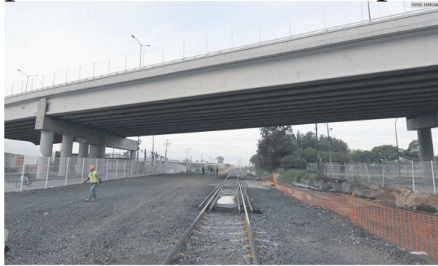
PROYECTO. Las obras de la Línea 4 del Tren Ligero de Tlajomulco llevan casi el 20% de avance, pero se espera que esté concluida el próximo año.
