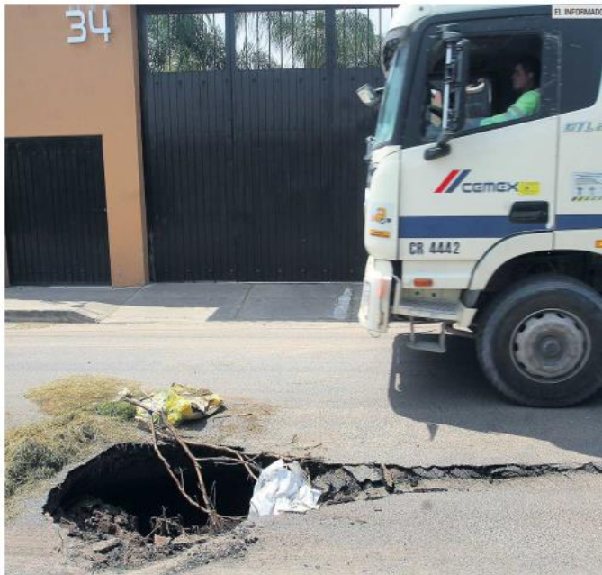
DETERIOROS. Diversos socavones han aparecido en la ciudad en la temporada de lluvias.
